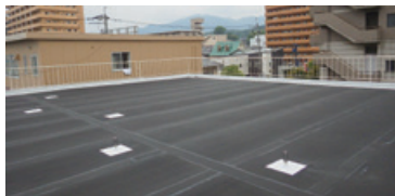
下地接着力、接合部強度と施工性が向上したゴムシートを用い、環境負荷が少ない“ファストバック工法”
