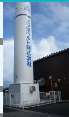
LNGサテライト（四国工場）
