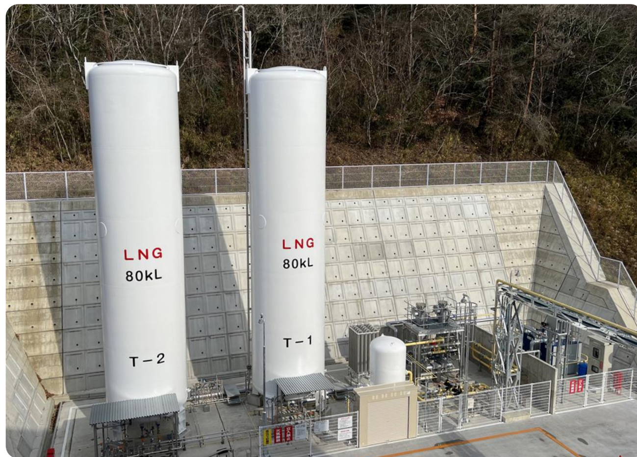
重油から環境負荷の低いLPGへの燃料転換に伴い新設されたLPGタンク（綾部事業所 | 2025年1月稼働）
